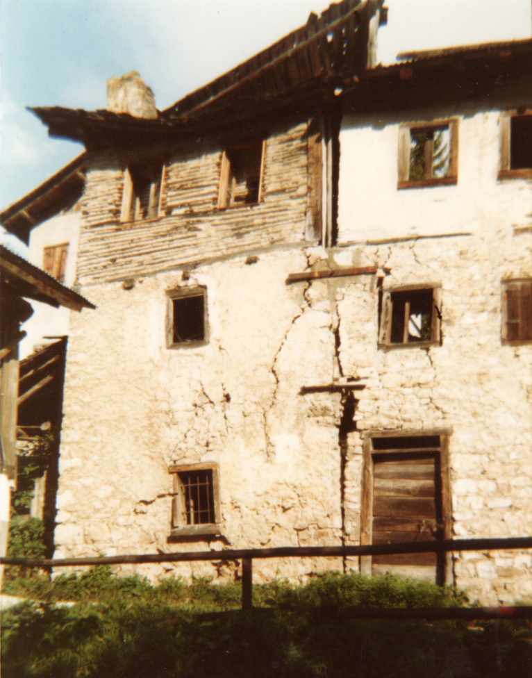
1981 DAMOS La casa della famiglia di Santo Da Damos qualche giorno prima di essere demolita. Sulla facciata si possono notare le numerose crepe che si accentuavano continuamente anche a causa degli scoppi della vicina cava
